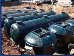
อัตราการบำบัด : 500 ลบ.ม./วัน ชนิดของระบบ : FFAS
