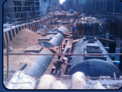
อัตราการบำบัด : 240 ลบ.ม./วัน ชนิดของระบบ : FFAS
