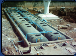
อัตราการบำบัด : 360 ลบ.ม./วัน ชนิดของระบบ : FFAS
