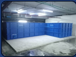
ถังบำบัดน้ำเสียทรงสี่เหลี่ยม
